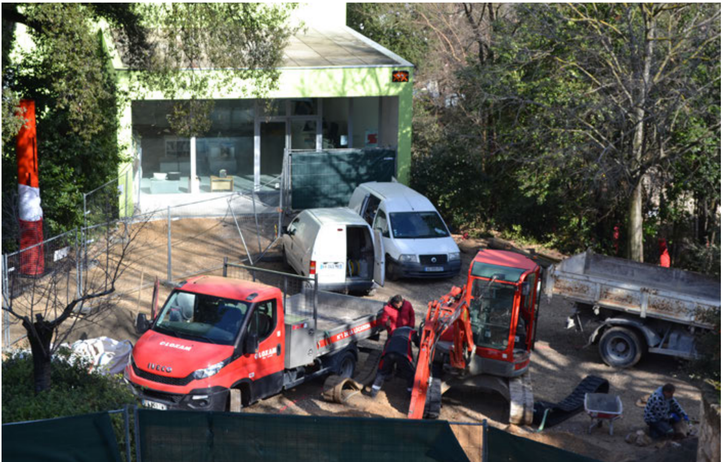
Travaux devant l'accès des réserves de la Donation Travaux devant le hall d'entrée de la Donation
